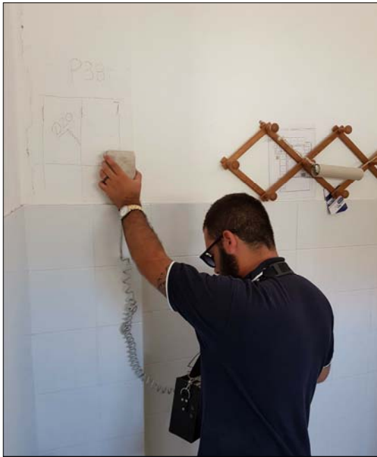
Ricostruzione schemi strutturali con ausilio dello strumento "Pachometro". Rilevati nel pilastro P38, sei ferri longitudinali Ø16 e staffe Ø6/20
