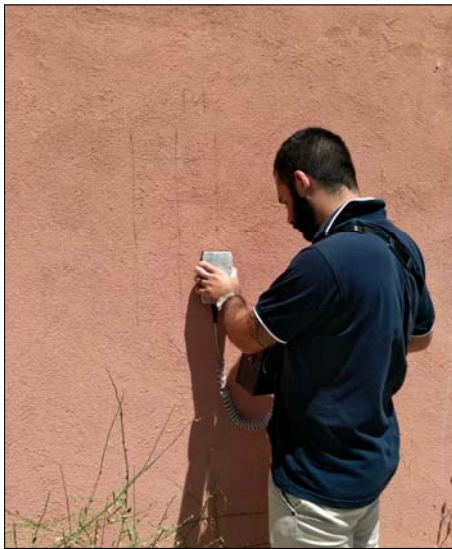
Ricostruzione schemi strutturali con ausilio dello strumento "Pachometro". Rilevati nel pilastro P4, sei ferri longitudinali \varnothing 16 e staffe \varnothing 6/16
