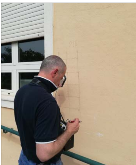
Ricostruzione schemi strutturali con ausilio dello strumento "Pachometro". Rilevati nel pilastro P15 sei ferri longitudinali lisci \varnothing 12 e staffe \varnothing 6/13
