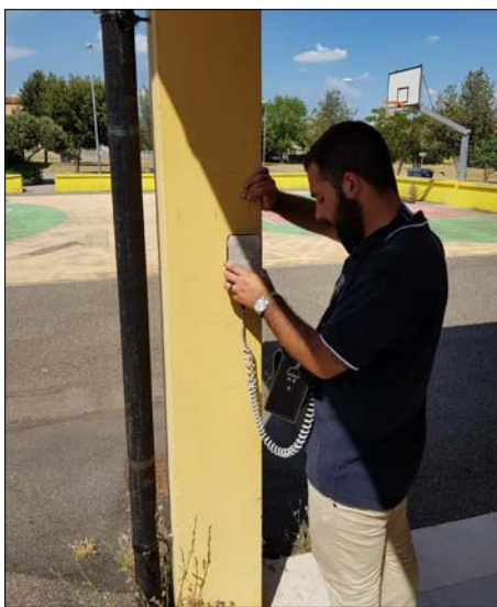
Ricostruzione schemi strutturali con ausilio dello strumento "Pachometro". Rilevati nel pilastro P23 sei ferri longitudinali \varnothing 12 e staffe \varnothing 8/21
