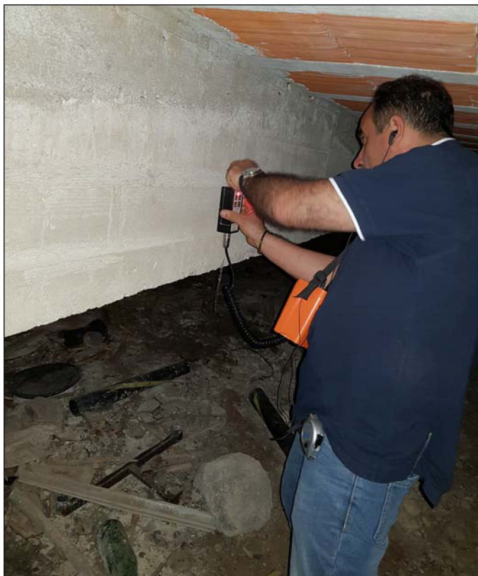
Ricostruzione schemi strutturali con ausilio dello strumento "Pachometro". Rilevati nelle travi T1 e T2 3 ferri longitudinali Ø22 e 2 ferri reggistaffe Ø16
