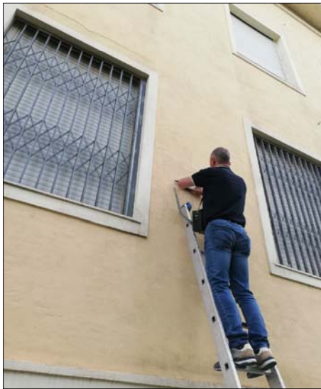
Ricostruzione schemi strutturali con ausilio dello strumento "Pachometro". Rilevati nel pilastro P8 sei ferri longitudinali \varnothing 14-16 e staffe \varnothing 6/14-16
