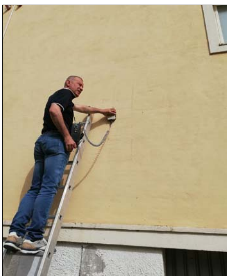
Ricostruzione schemi strutturali con ausilio dello strumento "Pachometro". Rilevati nel pilastro P10 quattro ferri longitudinali lisci \varnothing 12 e staffe \varnothing 6/13
