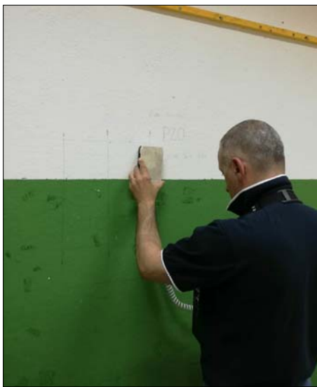
Ricostruzione schemi strutturali con ausilio dello strumento "Pachometro". Rilevati nel pilastro P20 sei ferri longitudinali \varnothing 14 e staffe \varnothing 6-8/12
