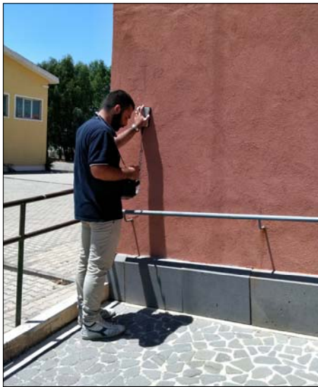
Ricostruzione schemi strutturali con ausilio dello strumento "Pachometro". Rilevati nel pilastro P2, quattro ferri longitudinali \varnothing 16 e staffe \varnothing 6/15-16
