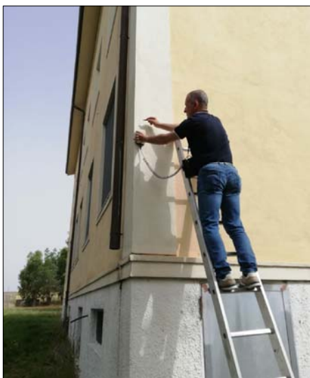
Ricostruzione schemi strutturali con ausilio dello strumento "Pachometro". Rilevati nei pilastri P9 e P49 sei ferri longitudinali \varnothing 16 e staffe \varnothing 6/15-16
