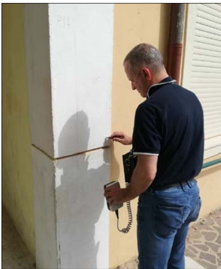
Ricostruzione schemi strutturali con ausilio dello strumento "Pachometro". Rilevati nel pilastro P14 sei ferri longitudinali \varnothing 16 e staffe \varnothing 10/13
