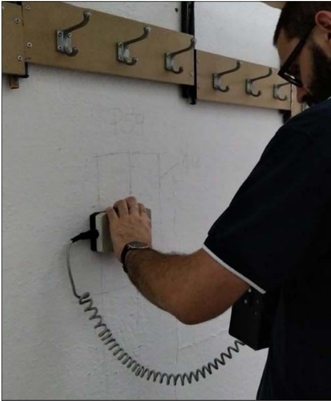
Ricostruzione schemi strutturali con ausilio dello strumento "Pachometro". Rilevati nel pilastro P59 al piano primo, sei ferri longitudinali \varnothing 16 e staffe \varnothing 6/16
