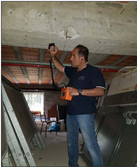
Ricostruzione schemi strutturali con ausilio dello strumento "Pachometro". Rilevati nelle travi T5, T6 e T7 cinque ferri \varnothing 16 e staffe \varnothing 9/25
