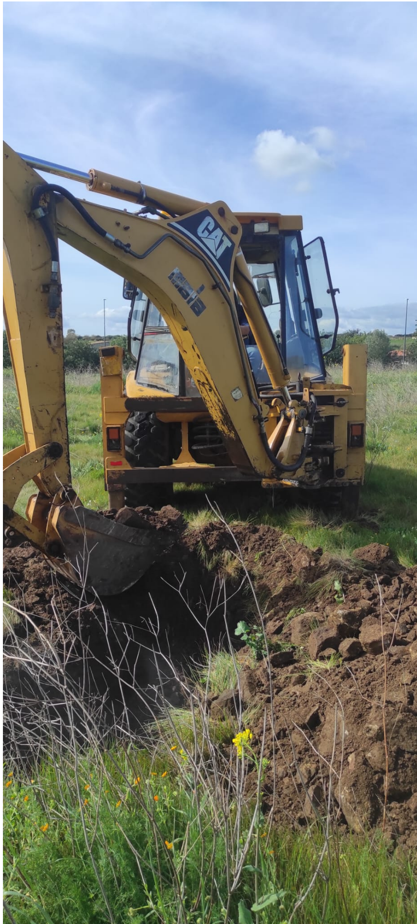
POSTAZIONE POZZETTO P3BIS
